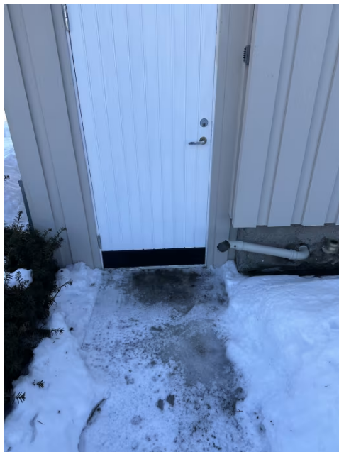
Det registreres fall inn mot kjellernedgang.
