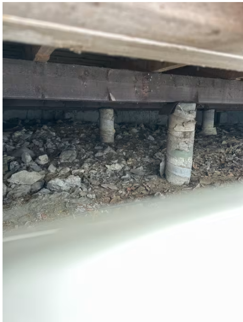
Det registreres stedvis skjevheter ved fundamenter.
