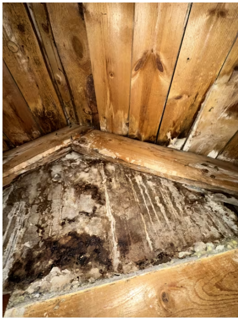
Det er påvist fuktskjolder i undertak/takkonstruksjon.
