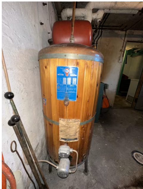
Viser varmtvannsbereder fra 1963.
