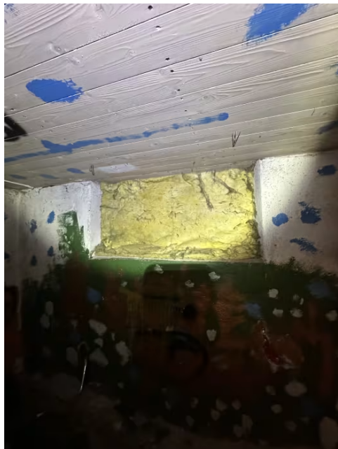
Det registreres manglende kjellervindu. Tettet med isolasjon.
