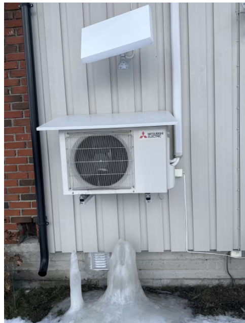
Viser utedel på varmepumpen. Det registreres store mengder is under varmepumpe.
