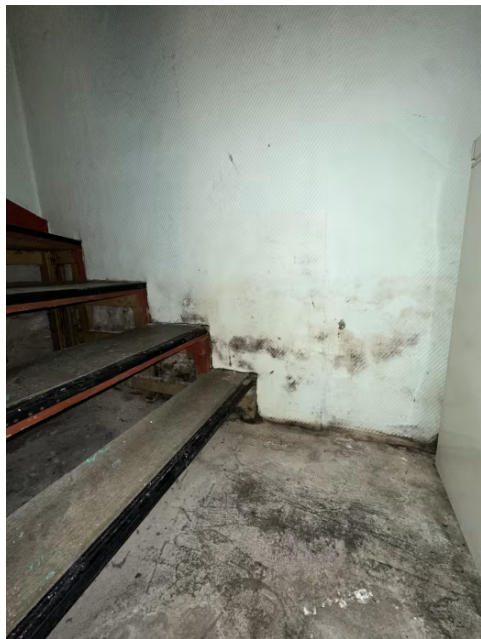
Viser fuktighet og svertesopp ved kjellertrapp.
