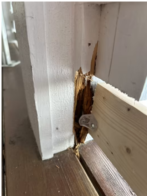
Råteskade ved søyle på terrasse. Eier informerer om at søyle vil bli utbedret før salg.
