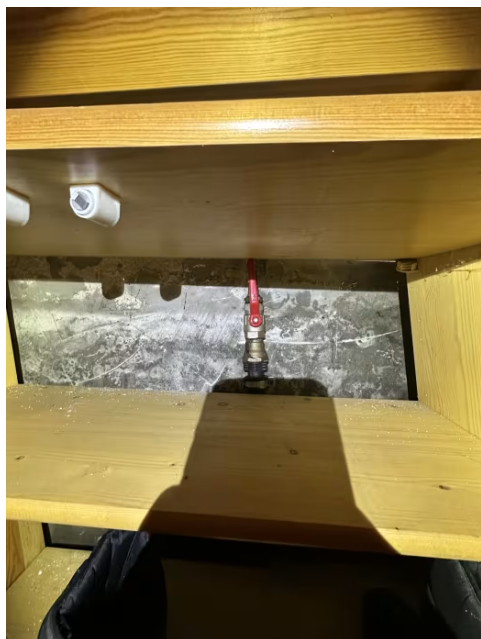
Viser hovedstoppekran i kjellerrom.
