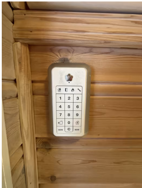
Boligen er installert med alarm.
