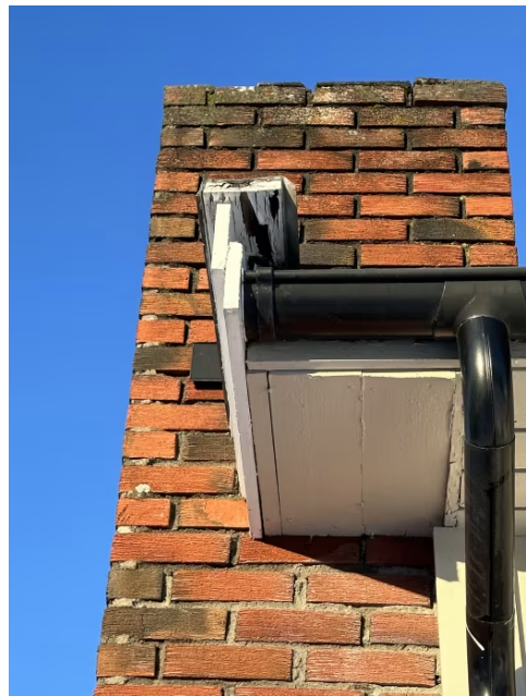
Det registreres slitasje/ råte ved isbordbeslag.
