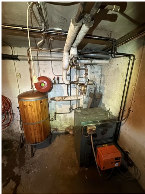
Viser eldre fyringsanlegg i kjeller.
