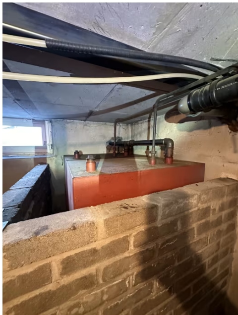
Viser innmurt oljetank i kjeller.
