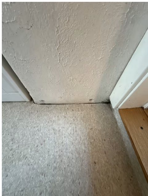
Viser manglende oppbrett av belegg.
