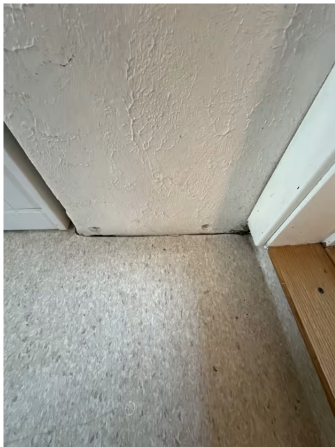
Viser manglende oppbrett av belegg.
