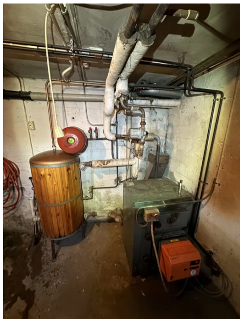
Viser eldre fyringsanlegg i kjeller.
