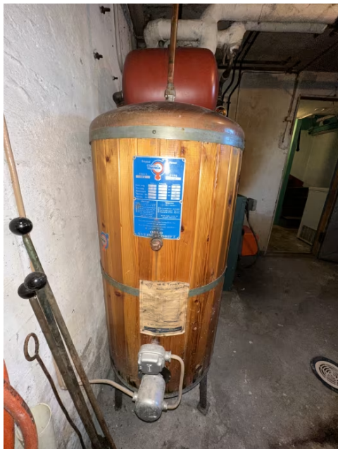
Viser varmtvannsbereder fra 1963.
