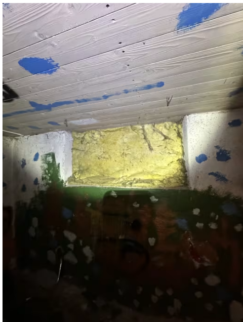
Det registreres manglende kjellervindu. Tettet med isolasjon.
