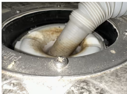
Viser plastsluk med synlig belegget under klemring.
