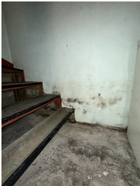
Viser fuktighet og svertesopp ved kjellertrapp.
