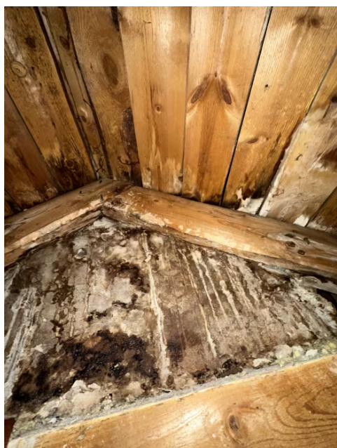
Det er påvist fuktskjolder i undertak/takkonstruksjon.
