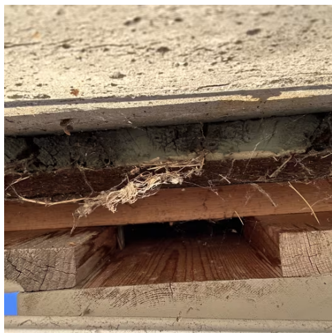
Viser klosser som musesperre bak kledningen.
