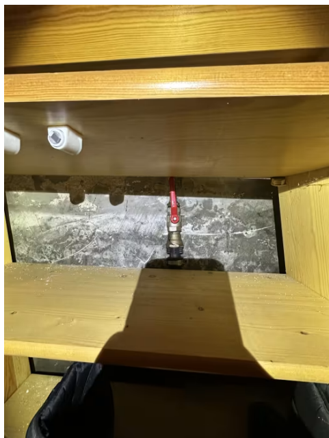
Viser hovedstoppekran i kjellerrom.
