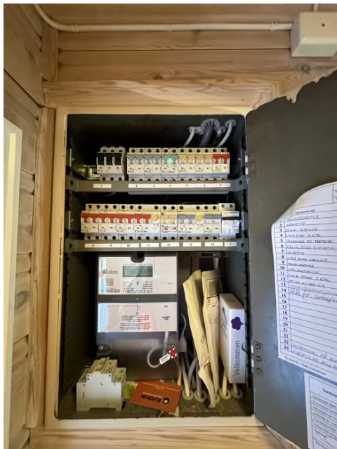
Viser innfelt sikringskap plassert i gang.
