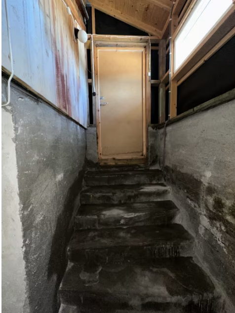
Synlig vann og is i trapperom til kjeller. Fuktopptrekk i dør.
