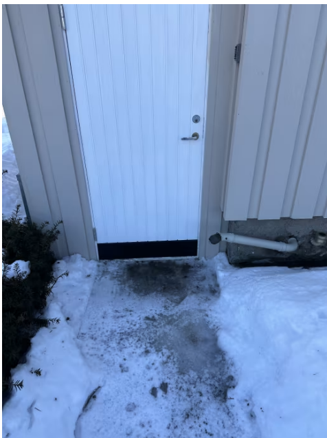
Det registreres fall inn mot kjellernedgang.
