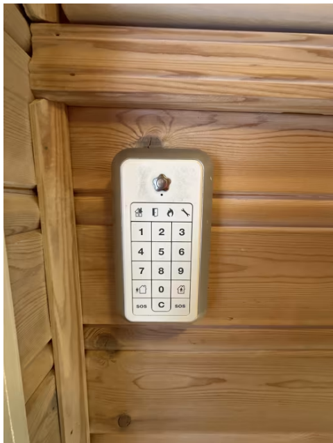
Boligen er installert med alarm.
