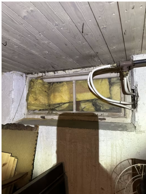
Viser knust vindu i kjeller. Antatt adkomst til krypkjeller.
