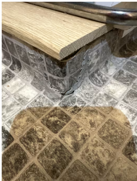
Viser sprekke i hjørne ved oppbrett av belegget.
