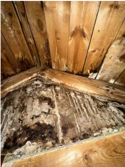
Det er påvist fuktskjolder i undertak/takkonstruksjon.
