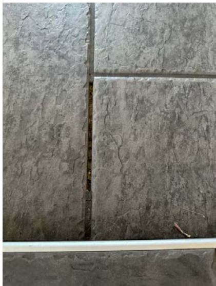
Det registreres sprekker i flisfuger ved gulv ved flere overflater..
