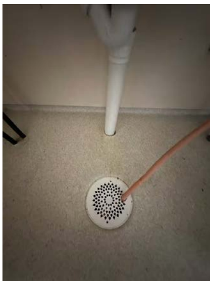
Rørføringer gjennom gulv har ingen synlig oppbrett/tetting rundt rør.
