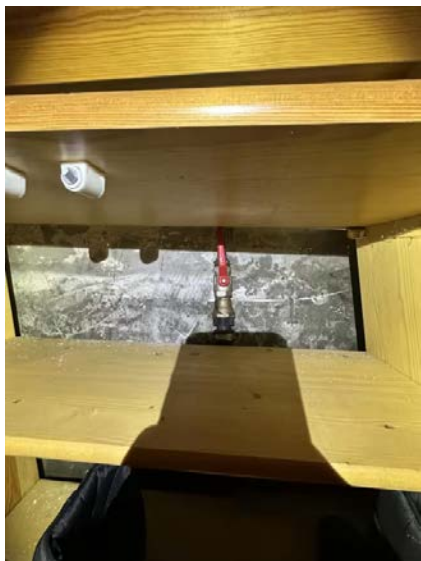
Viser hovedstoppekran i kjellerrom.
