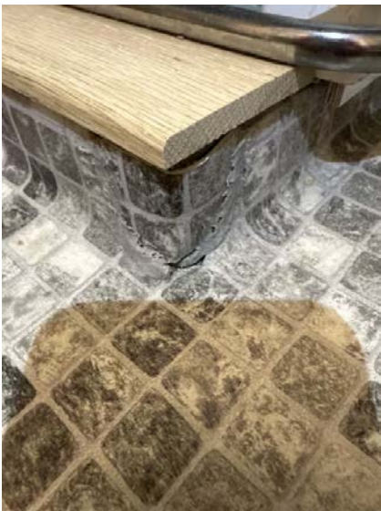
Viser sprekk i hjørne ved oppbrett av belegget.
