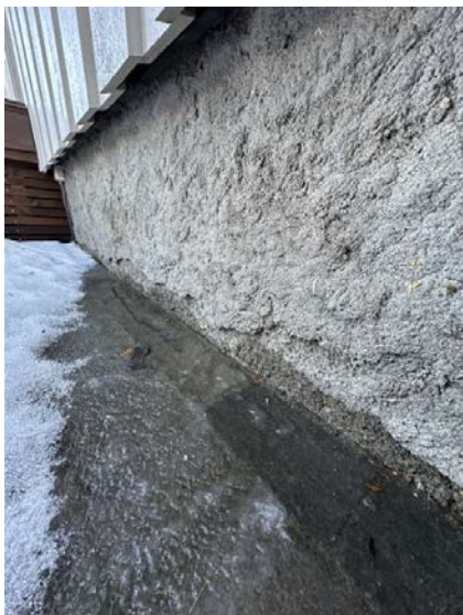
Grunnmur har stedvis avskalling ved puss.
