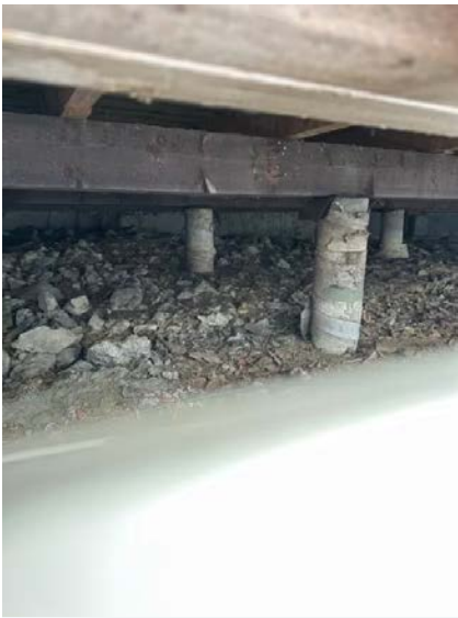
Det registreres stedvis skjevheter ved fundamentet.
