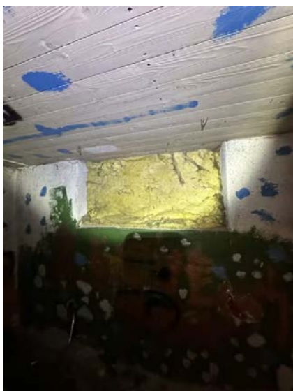
Det registreres manglende kjellervindu. Tettet med isolasjon.
