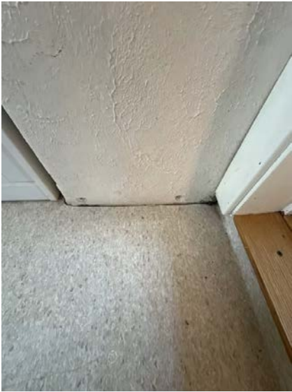
Viser manglende oppbrett av belegg.
