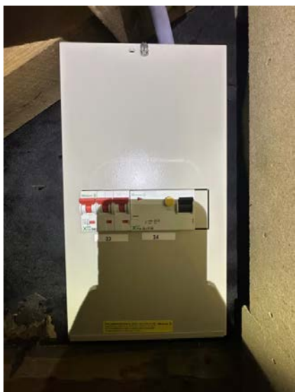
Viser inntak plassert i knekott. Overbelastningsvern på 40A og jordfeilbryter.
