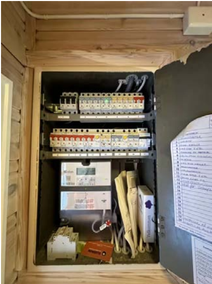
Viser innfelt sikringskap plassert i gang.
