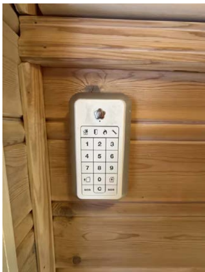
Boligen er installert med alarm.
