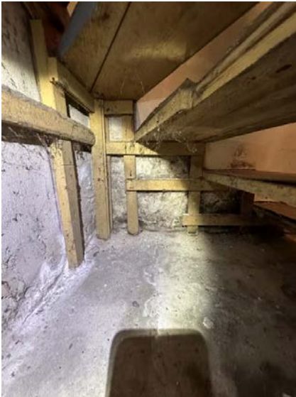
Trappen er påvirket av forholdene i kjeller. Enkelte råteskader på trapp.
