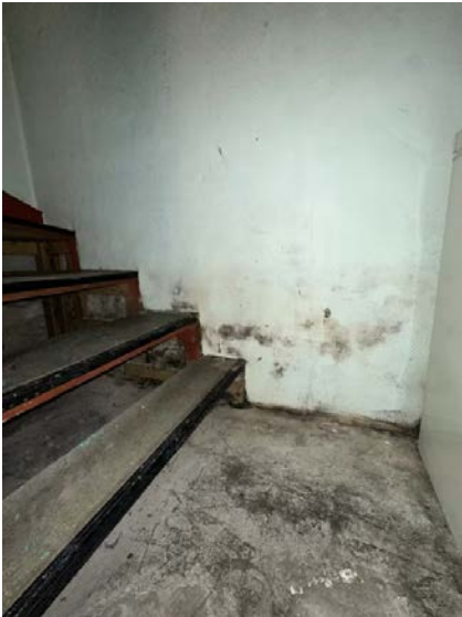
Viser fuktighet og svertesopp ved kjellertrapp.
