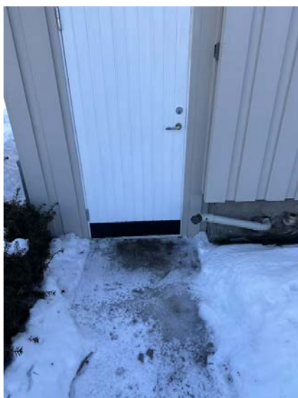
Det registreres fall inn mot kjellernedgang.
