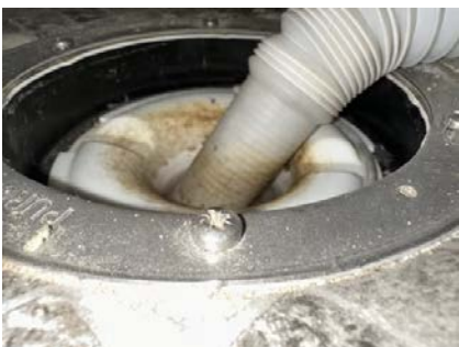
Viser plastsluk med synlig belegg under klemring.
