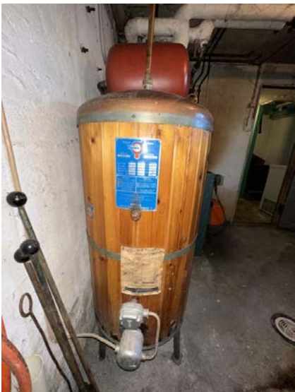
Viser varmtvannsbereder fra 1963.
