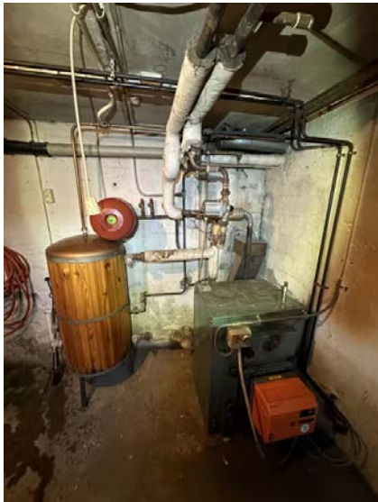
Viser eldre fyringsanlegg i kjeller.
