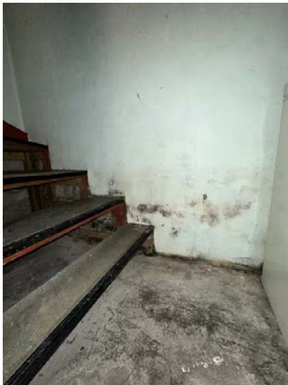
Viser fuktighet og svertesopp ved kjellertrapp.
