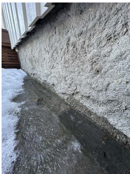
Grunnmur har stedvis avskalling ved puss.
