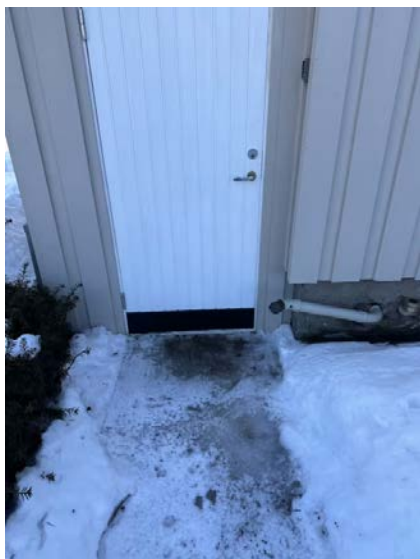
Det registreres fall inn mot kjellernedgang.
