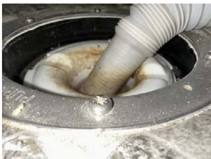
Viser plastsluk med synlig belegg under klemring.
