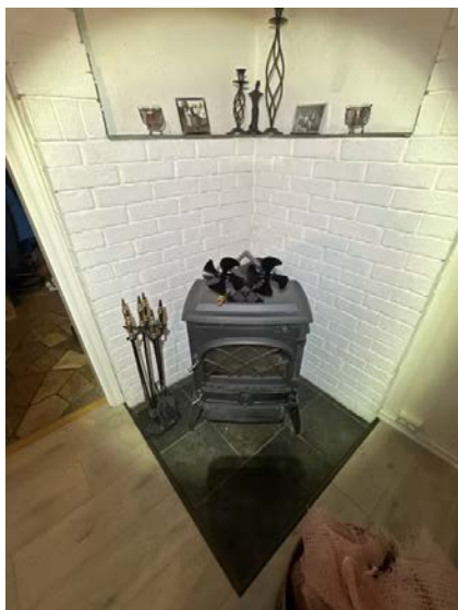
Viser vedovn i stue 1.etasje.
