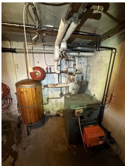
Viser eldre fyringsanlegg i kjeller.
