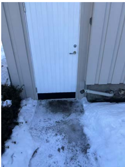
Det registreres fall inn mot kjellernedgang.
