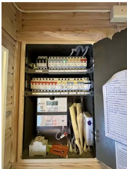
Viser innfelt sikringsskap plassert i gang.
