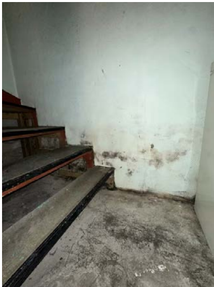
Viser fuktighet og svertesopp ved kjellertrapp.
