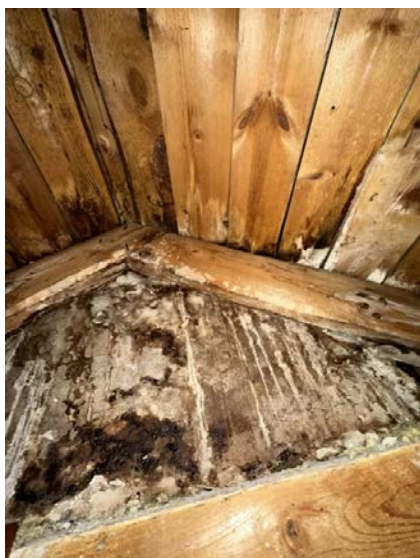
Det er påvist fuktskjolder i undertak/takkonstruksjon.
