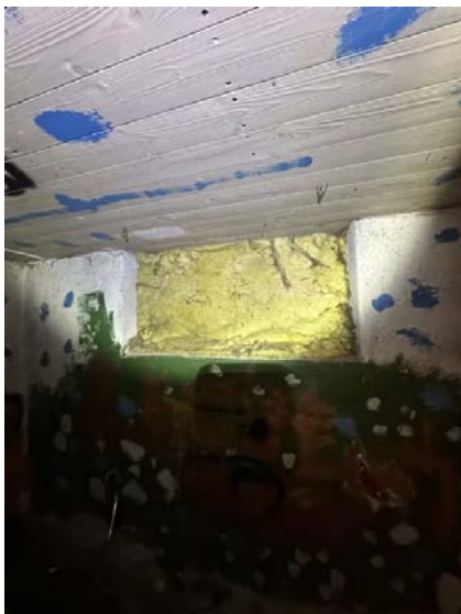
Det registreres manglende kjellervindu. Tettet med isolasjon.
