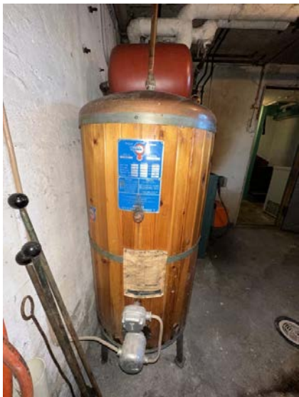
Viser varmtvannsbereder fra 1963.
