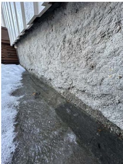
Grunnmur har stedvis avskalling ved puss.
