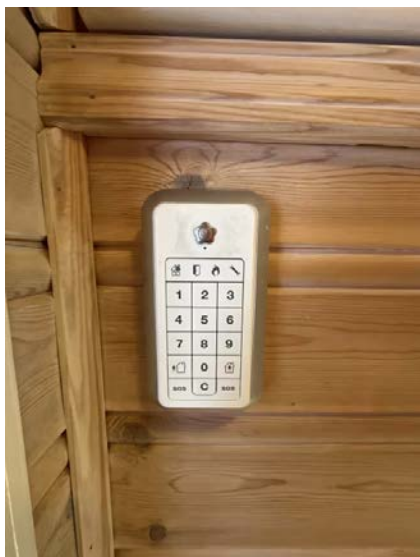
Boligen er installert med alarm.
