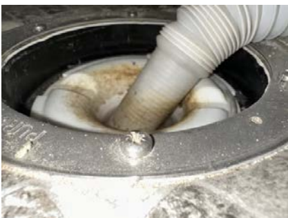
Viser plastsluk med synlig belegg under klemring.
