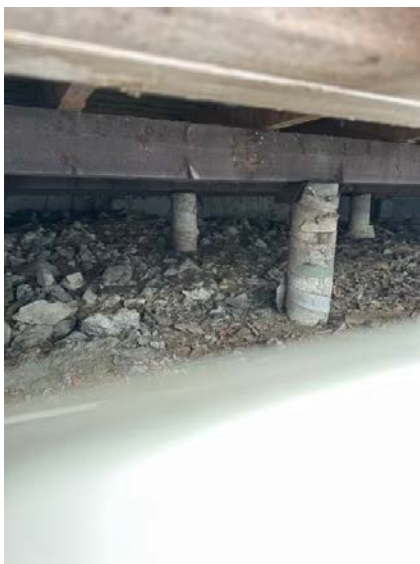
Det registreres stedvis skjevheter ved fundamenter.
