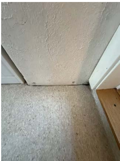
Viser manglende oppbrett av belegg.
