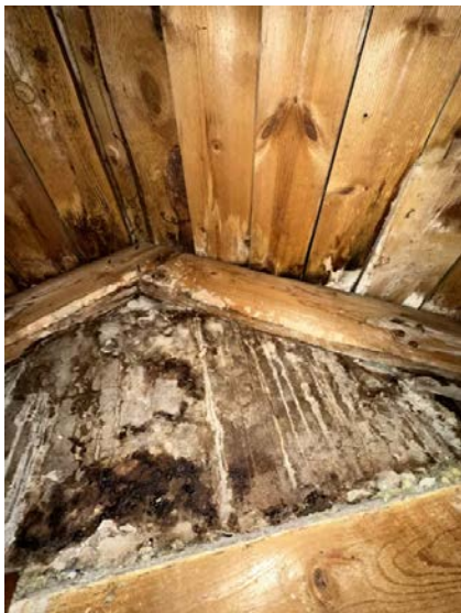
Det er påvist fuktskjolder i undertak/takkonstruksjon.
