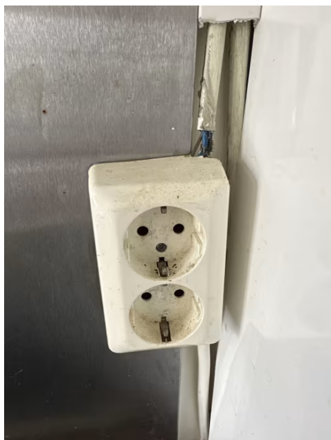
Viser stikkontakt med noe fagmessig utførelse.
