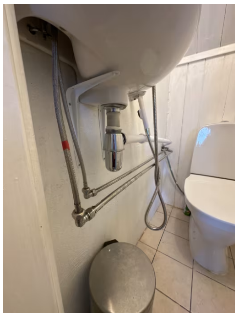
Rørstrekk på toalettrom er ikke betryggende festet.
