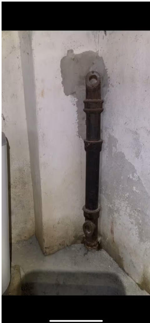
Viser eldre avløpsrør i kjeller.
