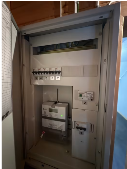
Viser sikringsskap plassert i bod 2.etasje
