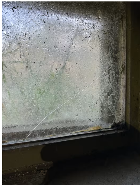
Viser sprukket glass i kjeller.
