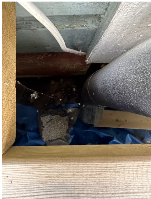
Nedløpsrør uten etablert drenerør under terrasse.
