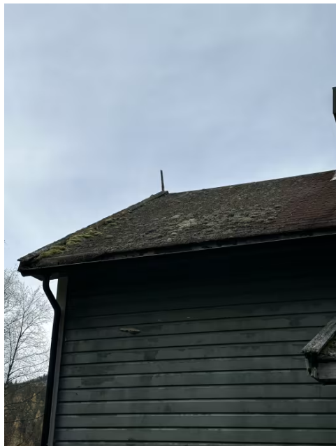
Takflater med generelt omfang av mosedannelse.
