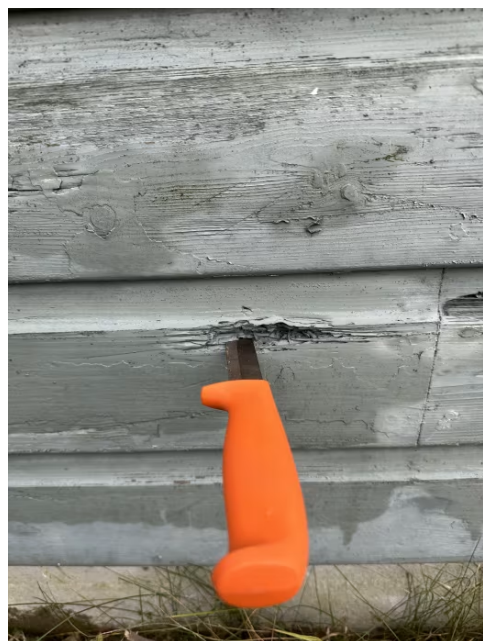
Viser råteskader i kledningen.
