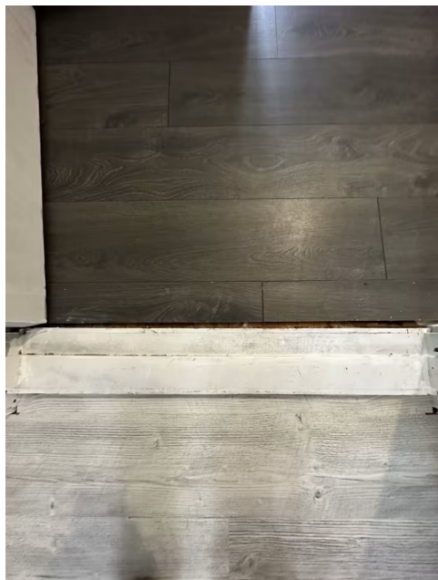
Overflater etablert med noe varierende håndverksmessig utførelse.
