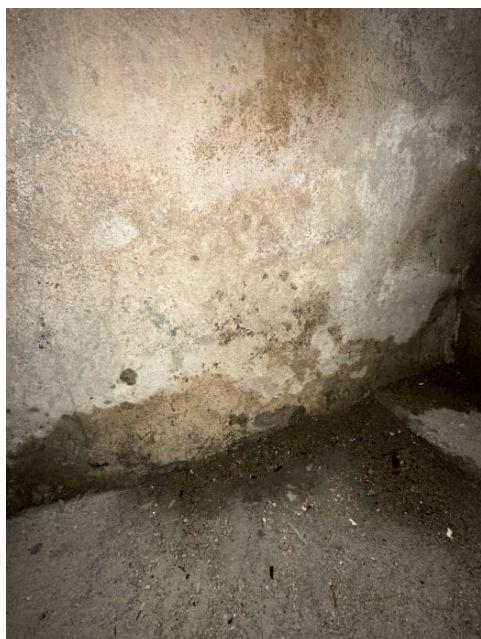
Viser fuktgjennomslag i grunnmur i kjeller.
