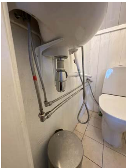
Rørstrekk på toalettrom er ikke betryggende festet.
