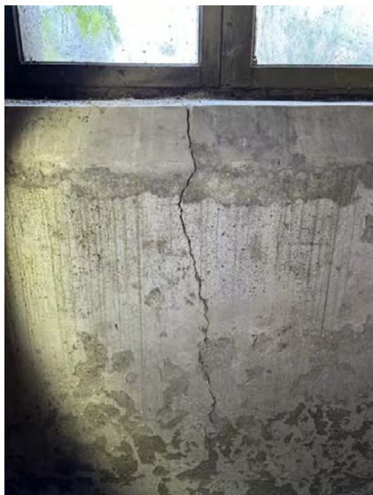
Viser sprekke i grunnmur. Bilde tatt i kjeller.
