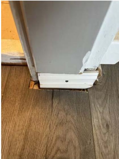
Listing fremstår og blitt utført på egeninnsats med varierende håndverksmessig utførelse.
