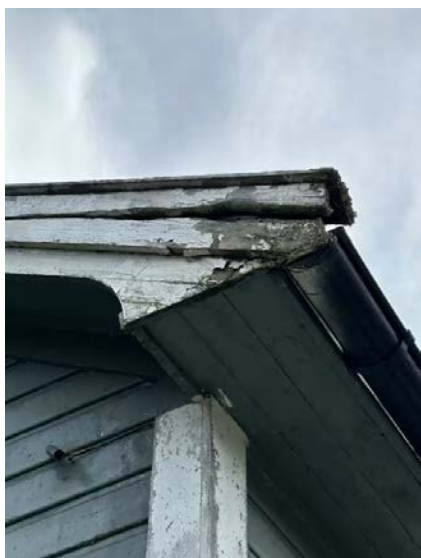
Vindskier og isbord med mosedannelse, generell slitasje og råteskader.
