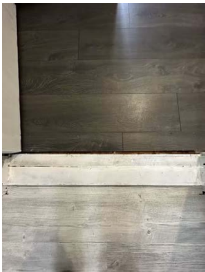
Overflater etablert med noe varierende håndverksmessig utførelse.
