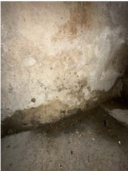
Viser fuktgjennomslag i grunnmur i kjeller.
