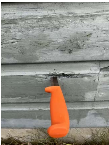
Viser råteskader i kledningen.
