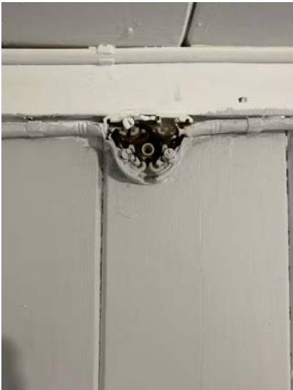
Eldre koblingssboks mangler lokk.
