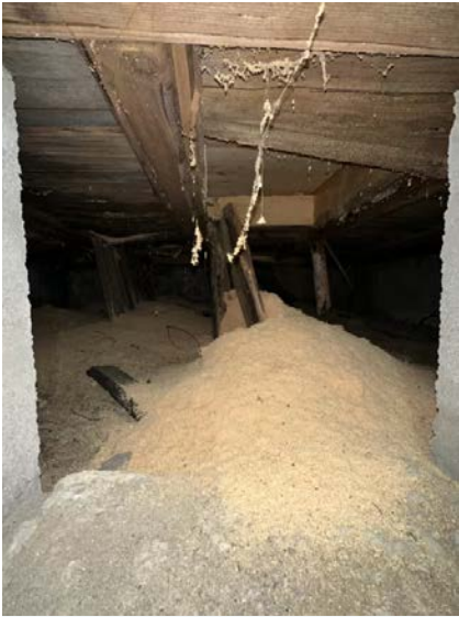
Deler av stubbloftkledningen og isolasjon i krypkjeller har løsnet.
