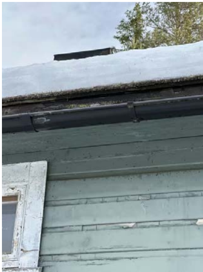
Forkantbeslag i overgang takfot og ned mot renne er ikke montert. Råteskader registreres.
