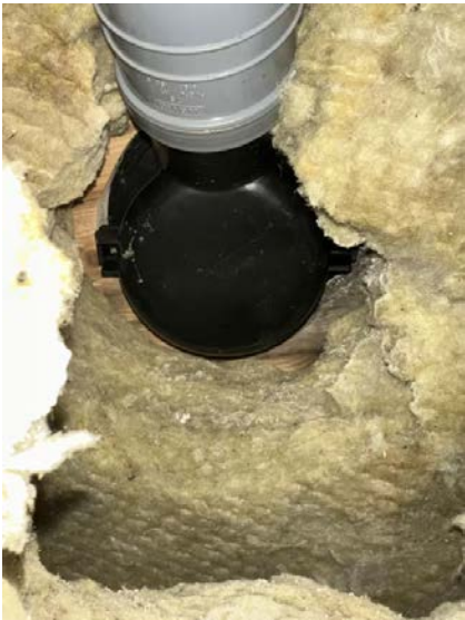
Viser sluk. Sluk inspisert fra åpninger i stubbloftkledningen.
