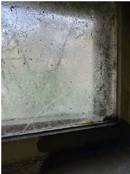
Viser sprukket glass i kjeller.
