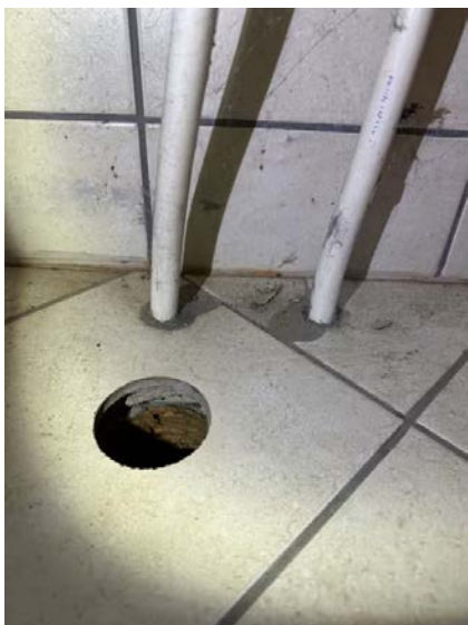
Viser hull i gulv på bad. Manglende bruk av membran/ mansjetter ved gjennomføringer.
