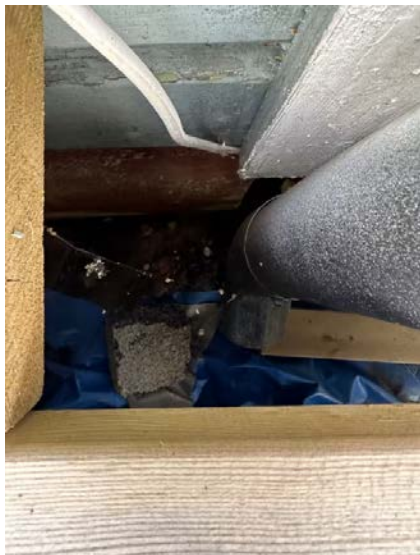
Nedløpsrør uten etablert drenerør under terrasse.
