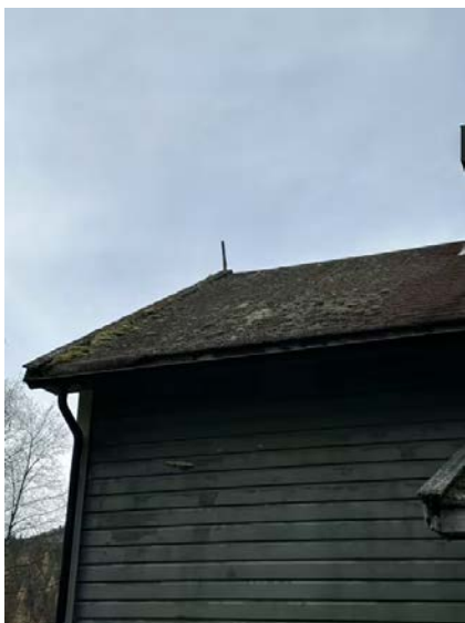
Takflater med generelt omfang av mosedannelse.
