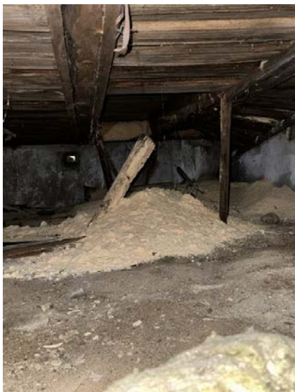
Viser råteskader i stubbloftkledning. Deler av stubbloftkledningen og isolasjon i krypkjeller har løsnet.
