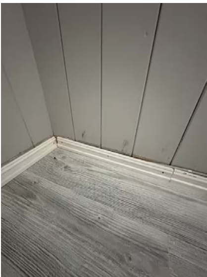
Listing med varierende håndverksmessig utførelse. Strømkabel ført bak listverk.
