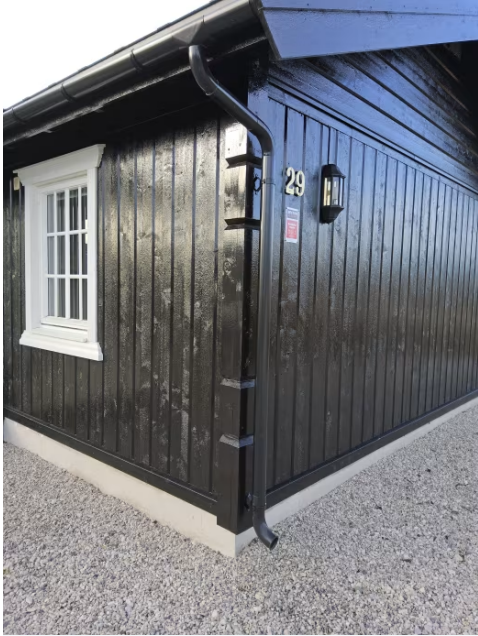
Bilde viser taknedløp avsluttet over bakken.
