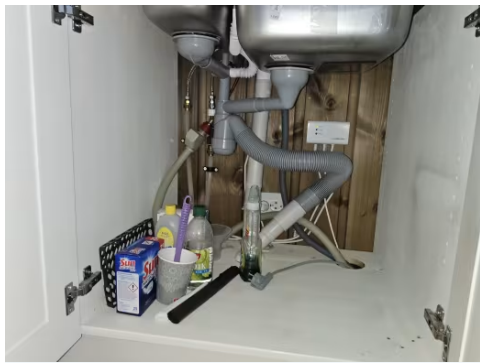
Bilde viser røropplegg på kjøkken.
