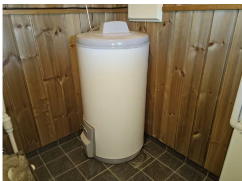
Bilde viser varmtvannsbereder.
