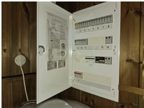
Bilde viser sikringsskap.
