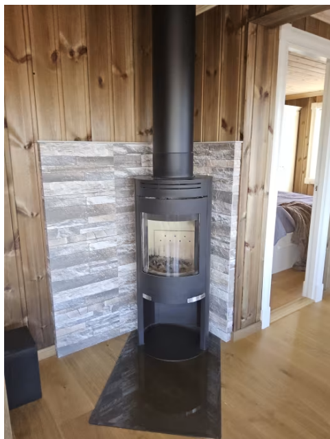
Bilde viser ildsted og deler av stålpipe.
