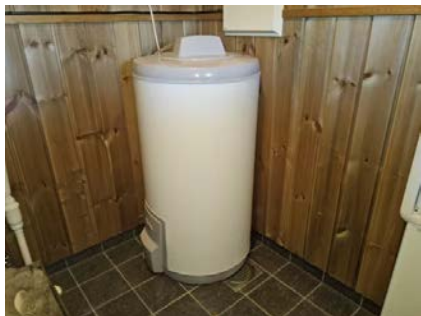
Bilde viser varmtvannsbereder.
