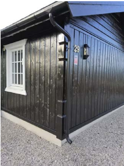
Bilde viser taknedløp.
