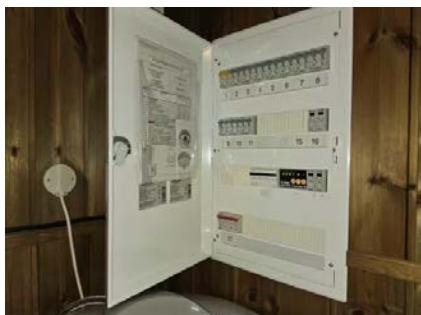
Bilde viser sikringsskap.
