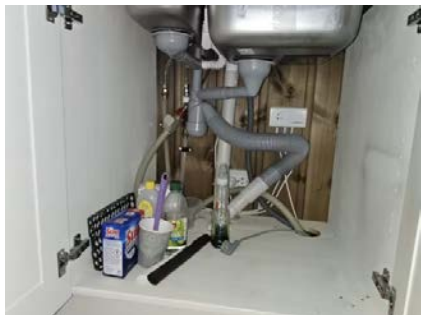
Bilde viser røropplegg på kjøkken.
