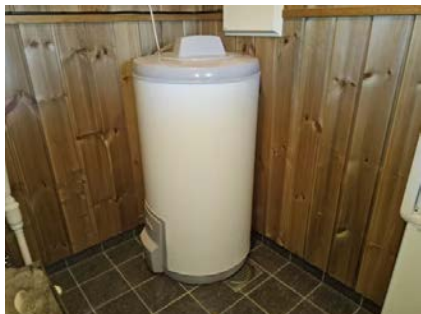
Bilde viser varmtvannsbereder.
