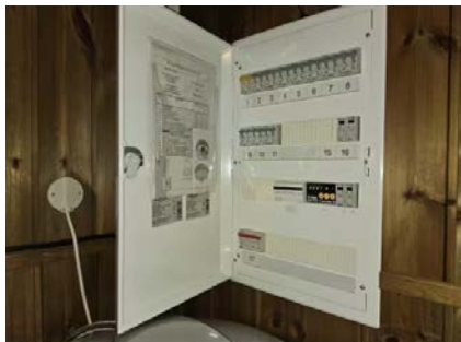
Bilde viser sikringsskap.
