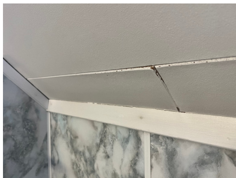
Fuktskader på himlingsplater.
