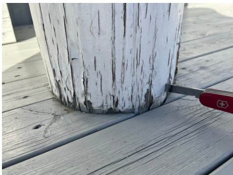
Søyle med tendens til røte.
