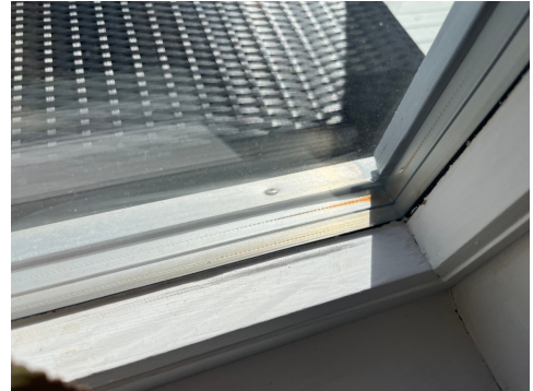
Stuevindu har tegn på kondens.
