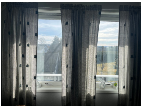
Vinduer med punktert glass.
