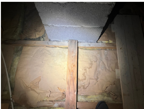
Fuktmerker på papp til isolasjon.
