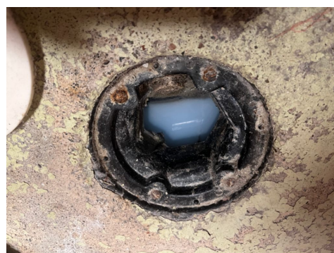
Sluk på vaskerom.
