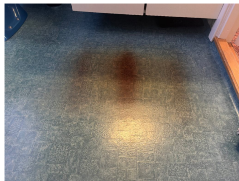
Belegg har merker etter varmekabler.
