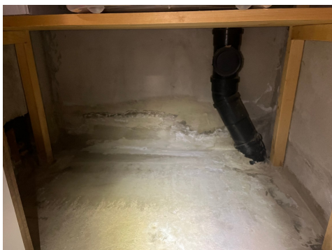
Saltutslag på vegg under trapp der eier har behandlet gulv/vegg.
