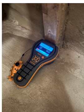
Fuktmåling i trevirke viste over grensen til skadelig fukt.
