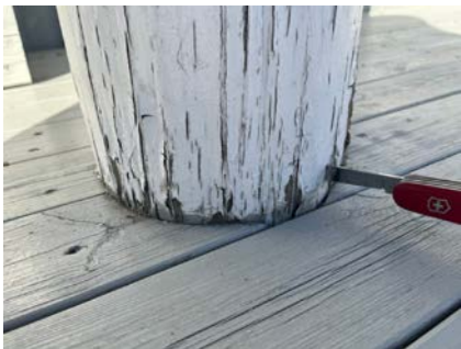
Søyle med tendens til råte.
