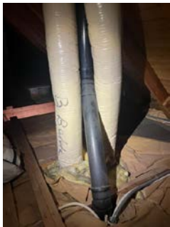
Uisolert rør for avløpsluftung på møneloft.
