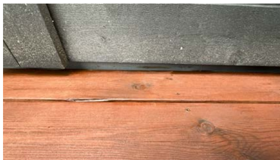
Synlig sveisemembran mot vegg i 2.etg
