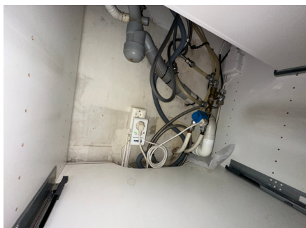
Røropplegg i kjøkkenbenk med Waterguard
