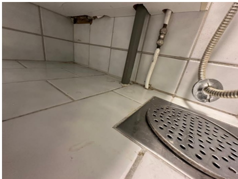
Sprekkdannelse i fuger mellom veggfliser
