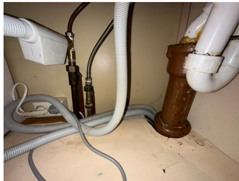
Røropplegg i kjøkkenbenk
