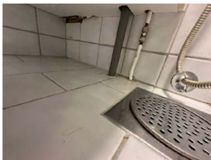
Sprekkdannelse i fuger mellom veggfliser
