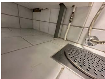
Sprekkdannelse i fuger mellom veggfliser
