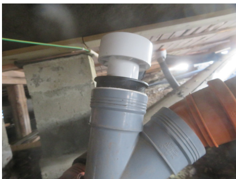
Lufting av avløp med "Durgoventil" under hytta.
