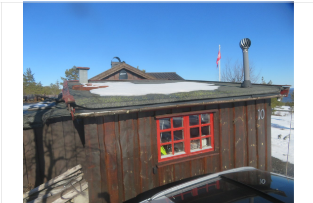
Slitt takteking og takrenner på uthus/anneks.
