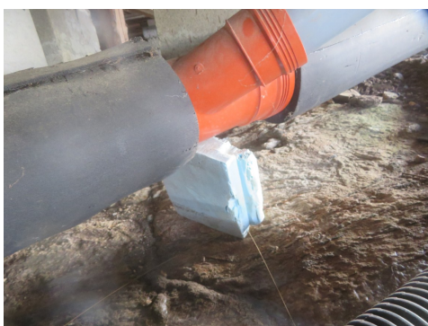
Ikke tilfredstillende montering av avløpsrør
