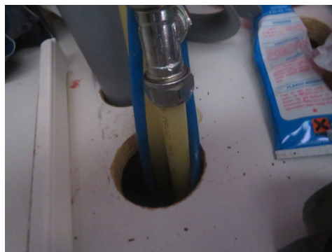
Vannledninger på kjøkken.
