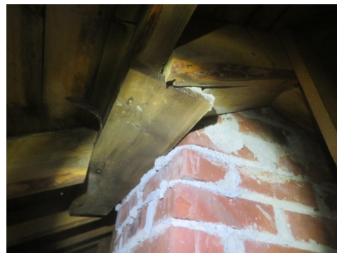
Misfarging i undertak ved pipe.
