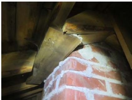
Misfarging i undertak ved pipe.
