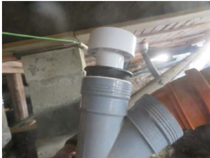
Lufting av avløp med "Durgoventil" under hytta.
