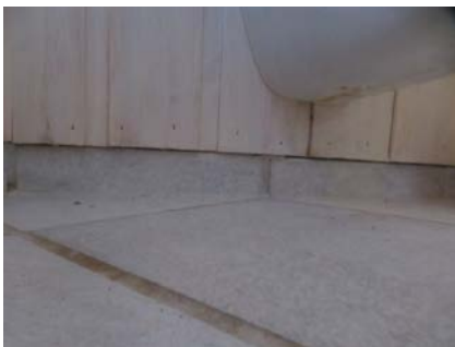
Veggmontert wc uten synlig lekkasjesikring
