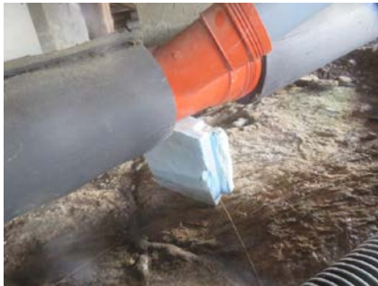
Ikke tilfredstillende montering av avløpsrør
