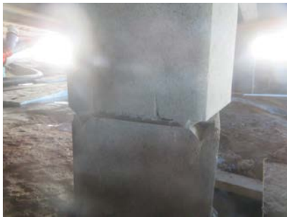
Plassbygget "skjev" pilar.
