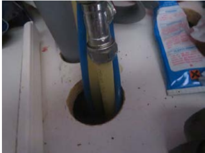
Vannledninger på kjøkken.
