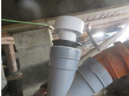
Lufting av avløp med "Durgoventil" under hytta.
