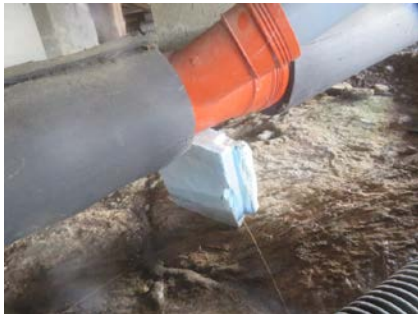
Ikke tilfredstillende montering av avløpsrør
