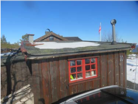
Slitt taktecking og takrenner på uthus/anneks.
