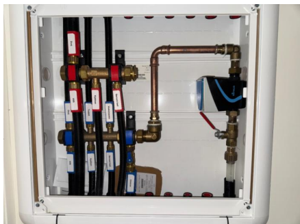
Vannfordelerskap i innvendig bod
