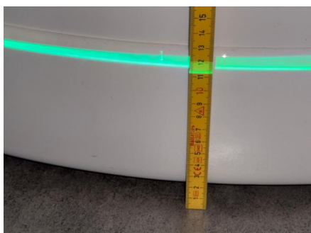
Fallforhold ca. 114 mm overkant gulv foran dusjkabinett (ved sluk)
