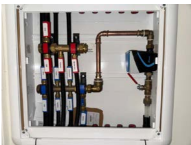
Vannfordelerskap i innvendig bod
