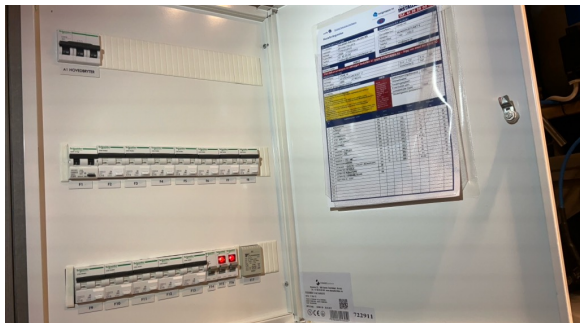
Sikringsskap i bod.
