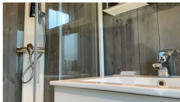
Manglende membran på vegg bak dusjkabinett og rundt servant. Dette er et avvik som erfaringsvis ofte sees på fritidsboliger som dette. Forholdet gis tilstandsgrad 3 i henhold til NS3600.
