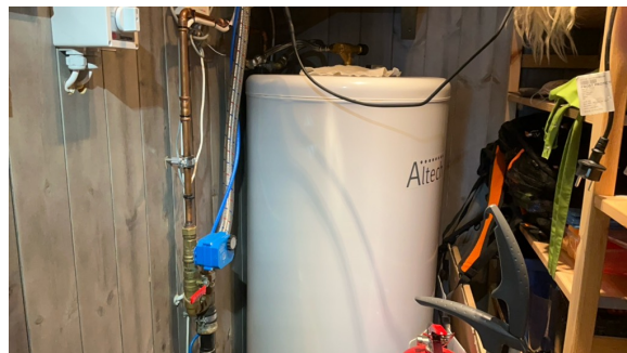
Stoppekran og trykktank i bod.
