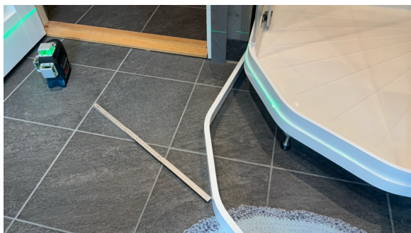
Fallforhold under dusjkabinett er ikke målt.
