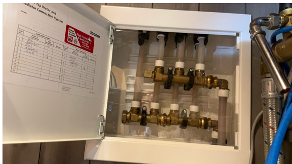
Fordelerskap i bod.
