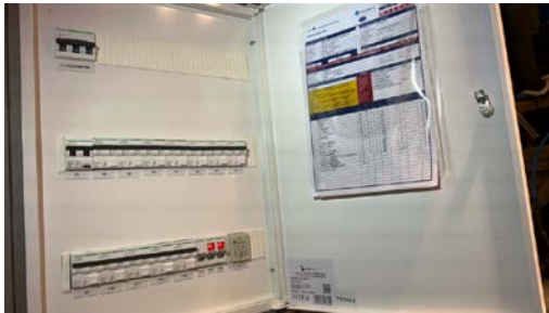
Sikringsskap i bod.
