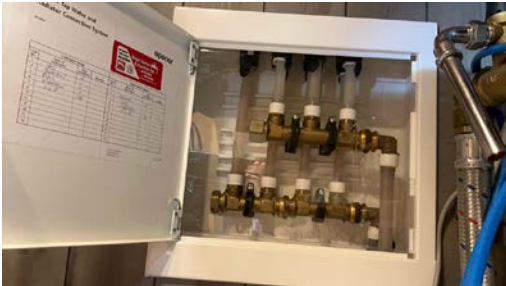
Fordelerskap i bod.
