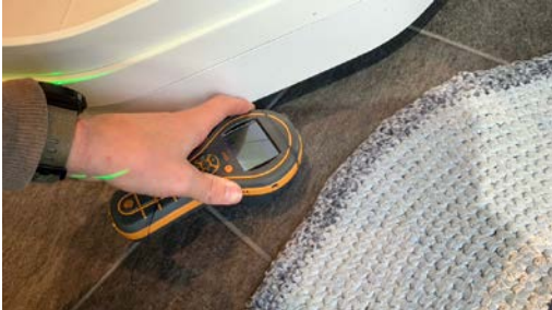
Enkle fuktsøk viste normale verdier.
