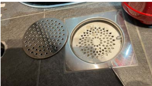
Sluk i bod. Dobbel slukrist, underliggende slukrist er ikke mulig å fjerne. Dette begrenser muligheten for rengjøring og inspeksjon.
