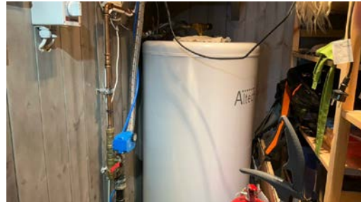
Stoppekran og trykktank i bod.
