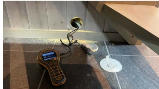
Hulltaking er utført i tilstøtende vegg mot dusjkabinett. Fuktmåling viste tørre verdier.
