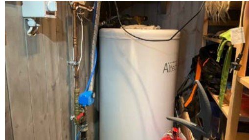
Stoppekran og trykktank i bod.
