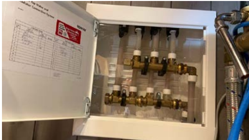
Fordelerskap i bod.
