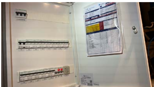
Sikringsskap i bod.
