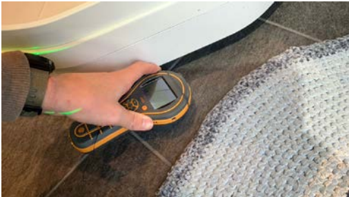
Enkle fuktsøk viste normale verdier.
