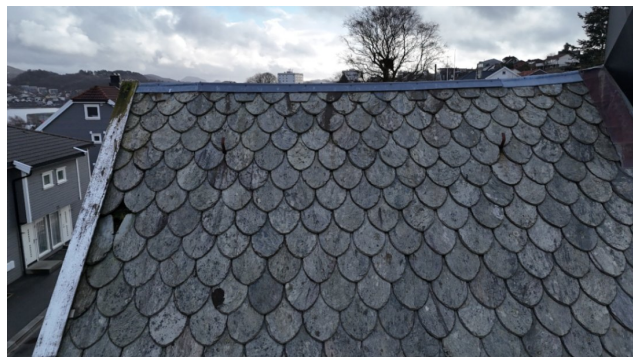
Bilde viser manglende takstein.
