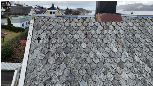
Bilde viser manglende takstein.
