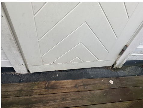
Fuktskader i nedre del av dørblad
