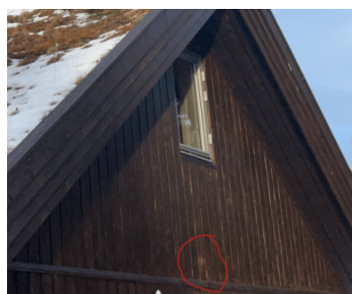
svært begrenset skader etter hakkespett på gavlvegg mot sør.
