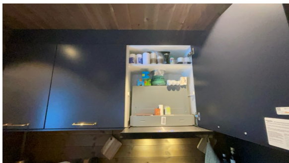
kjøkkenventilator med avtrekk ut.
