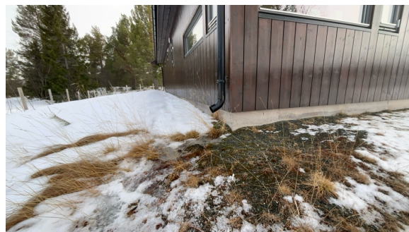
Taknedløp med utkast nordøstlig hjørne.
