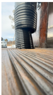
Skade på røroppstikk/ gjennomføring nordvestlig hjørne.
