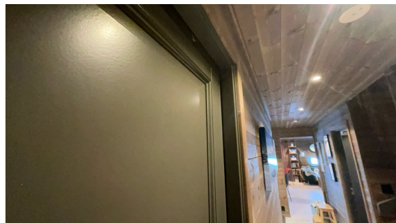
dør til soverom 1. i 1. etasje må justeres
