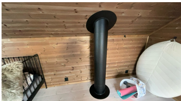
Isolert stålpipes i loftetasjen.
