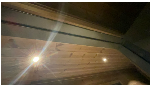
Merker etter kleshenger på soverom i 1. etasje.
