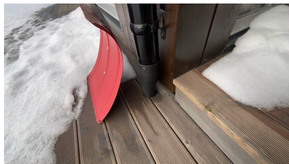
Røroppstikk/ gjennomføring sørvestlig hjørne.
