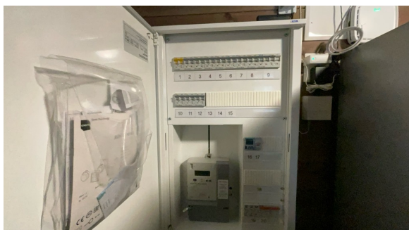
Sikringsskap plassert på bod
