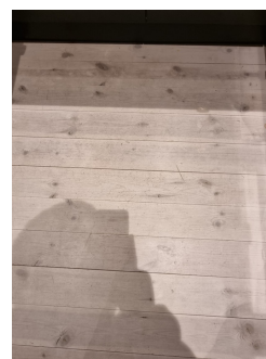
Det er påvist riper og sår i det beisede furugulvet på kjøkkenet.
