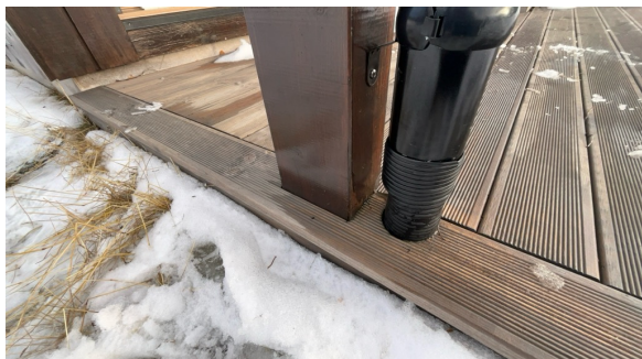
Avskalling av beis på søyle som følge av lekkasje fra taknedløp. Behov for normalt vedlikehold av overflater.
