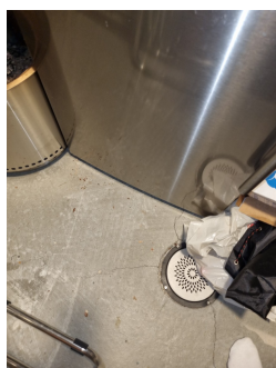
Det er registrert noen mindrevinnsprekker i betonggulvet i bod.
