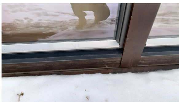
Avskalling av beis på kledning/vindusomramming. Behov normalt vedlikehold av overflater.
