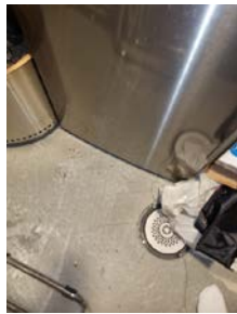
Det er registrert noen mindresvinnsprekker i betonggulvet i bod.
