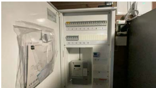
Sikringsskap plassert på bod
