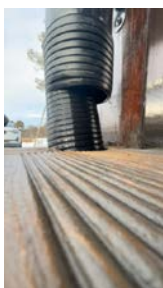
Skade på rørøppstikk/ gjennomføring nordvestlig hjørne.
