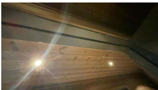
Merker etter kleshenger på soverom i 1. etasje.
