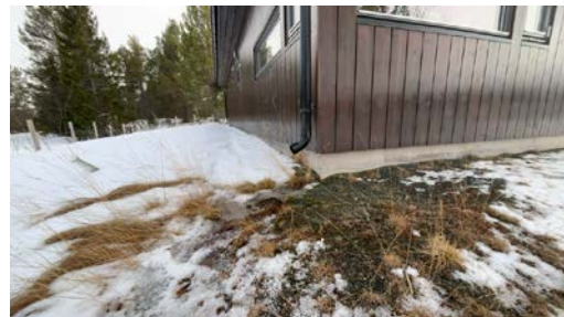
Taknedløp med utkast nordøstlig hjørne.
