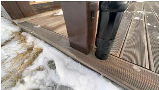
Avskalling av beis på søyle som følge av lekkasje fra taknedløp. Behov for normalt vedlikehold av overflater.
