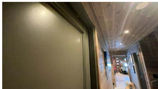
dør til soverom 1. i 1. etasje må justeres
