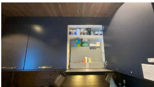
kjøkkenventilator med avtrekk ut.
