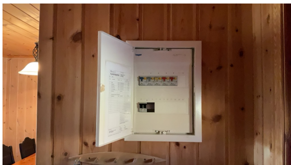
Sikringsskap plassert i entrè.
