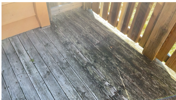
Slitasje på overflater.
