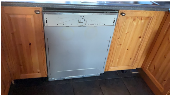
Oppvaskmaskin mangler front/dekkeplate.
