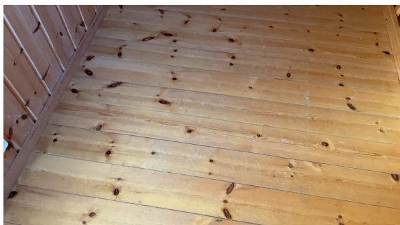
Slitasje på overflater.
