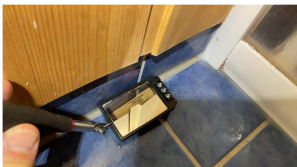
Ingen synlig membran bak panel i våtsone.
