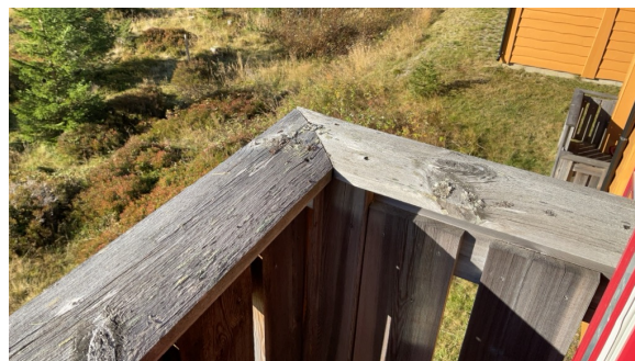
Slitasje på rekkverk.
