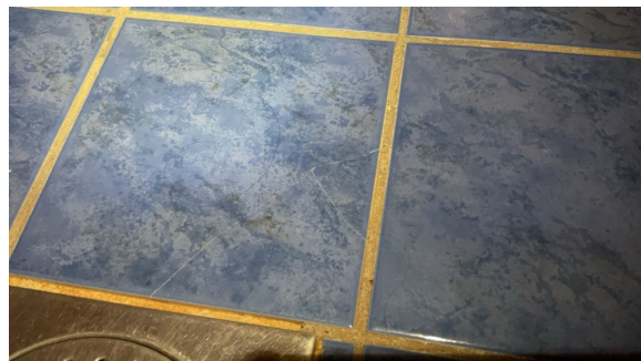
Sprekker i flis.
