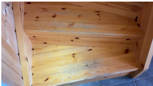
Slitasje på overflater.
