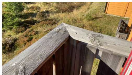
Slitasje på rekkverk.
