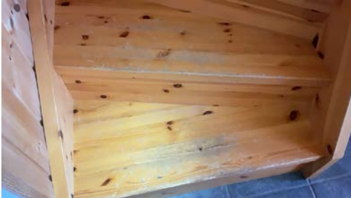
Slitasje på overflater.
