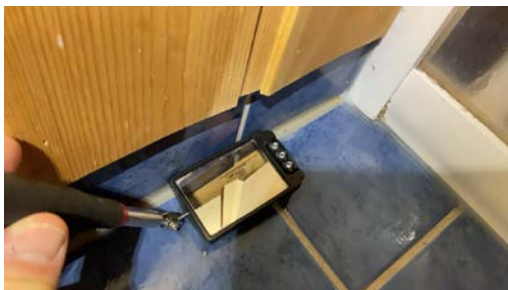
Ingen synlig membran bak panel i våtsone.
