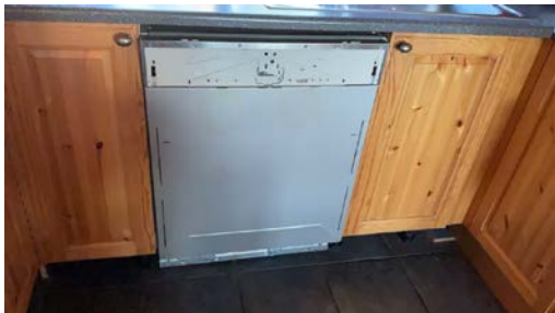
Oppvaskmaskin mangler front/dekkeplate.
