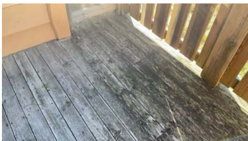
Slitasje på overflater.
