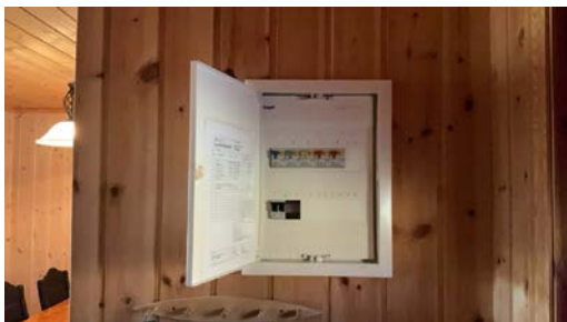
Sikringsskap plassert i entrè.
