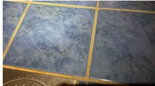
Sprekker i flis.
