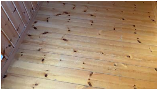
Slitasje på overflater.
