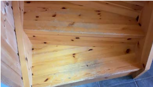
Slitasje på overflater.
