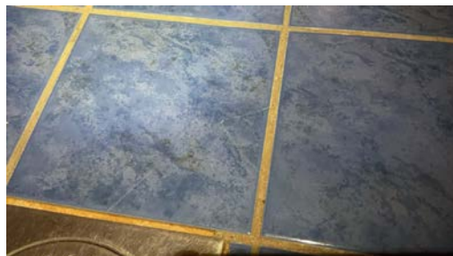
Sprekker i flis.
