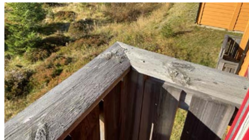
Slitasje på rekkverk.
