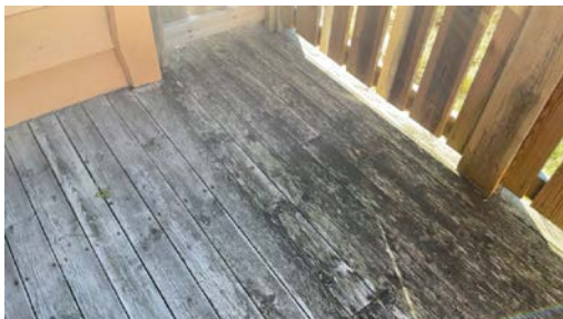
Slitasje på overflater.
