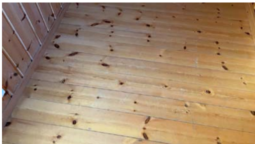
Slitasje på overflater.
