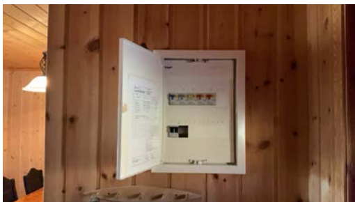
Sikringskap plassert i entrè.
