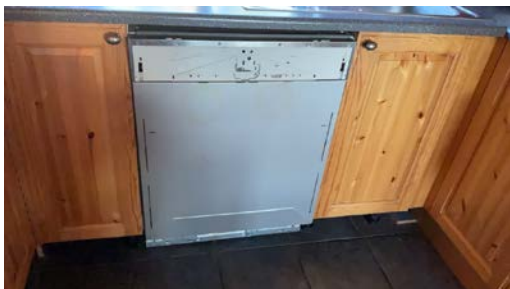
Oppvaskmaskin mangler front/dekkeplate.
