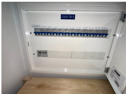
Sikringsskap med automatsikringer.
