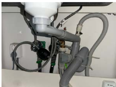
Røropplegg i kjøkkenbenk med Waterguard
