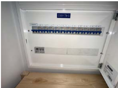
Sikringskap med automatsikringer.
