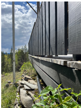
Synlig skjevhet i retning på bjelkelag.
