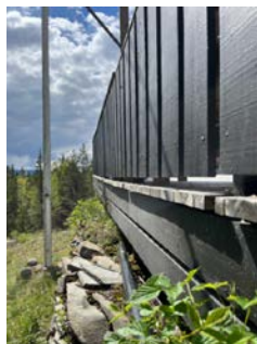
Synlig skjevhet i retning på bjelkelag.
