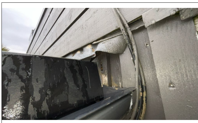
Unøyaktig finish på folie i overgang og mulighet for fukt/vanninntrengning ved nedbør.
