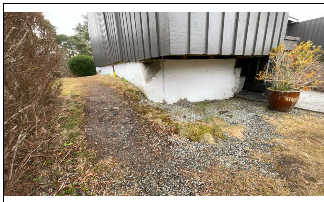
Tilbygg uten understøttelse. Her må det foreligge en beregning på bærekonstruksjoner når dette ble utført.
