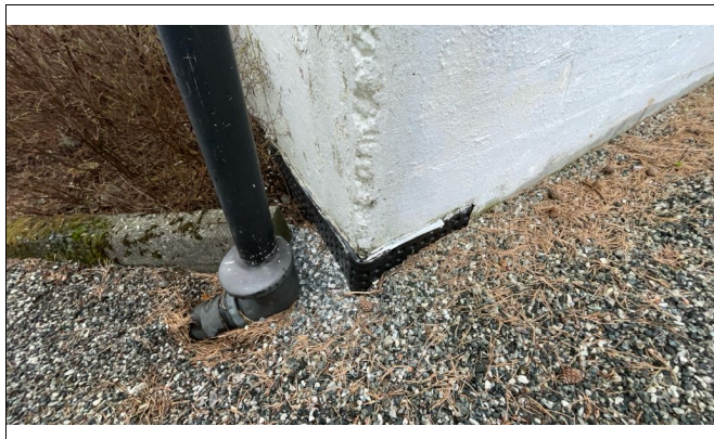
Knotteplast på del av grunnmur.
