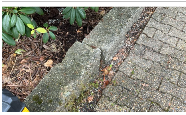
Sprekk i pyntemur ved inngang.
