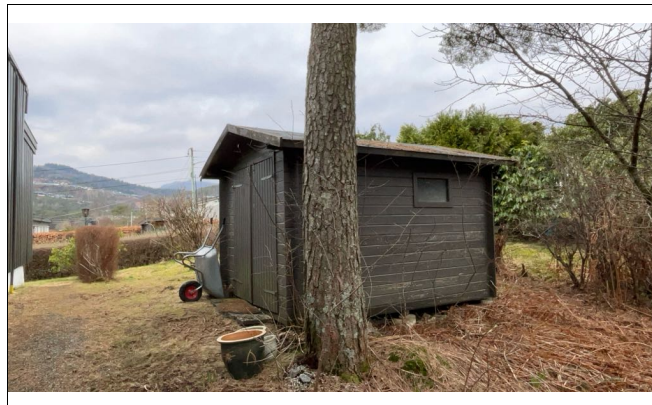
Malingsslitasje på bod.
