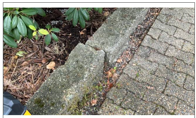
Sprekk i pyntemur ved inngang.
