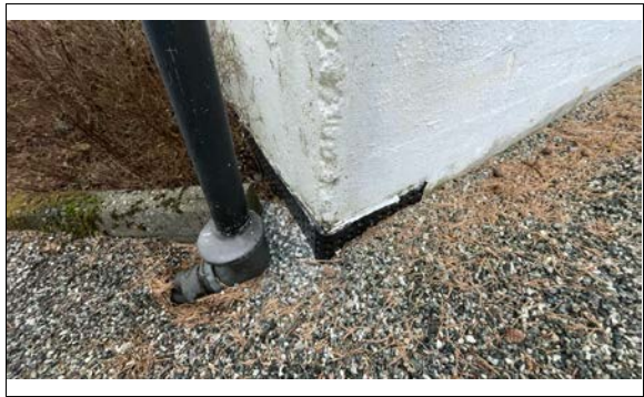
Knotteplast på del av grunnmur.
