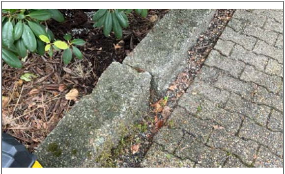
Sprekk i pyntemur ved inngang.
