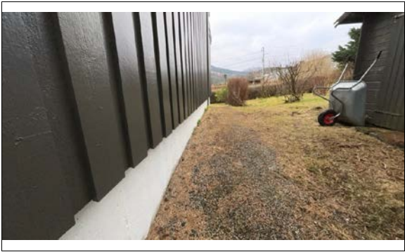
Drenering uten knotteplast på ende og flatt terreng mot bolig/grunnmur. Dagens boliger har krav til fall vekk fra bolig for å lede bort overflatevann.
