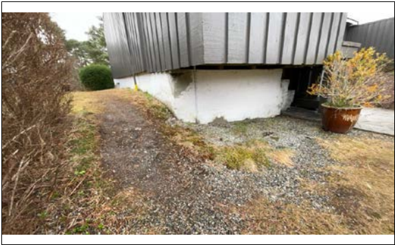
Tilbygg uten understøttelse. Her må det foreligge en beregning på bærekonstruksjoner når dette ble utført.
