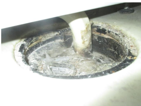
Sluk ved dusjkabinett.
