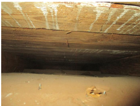
Ingen isolasjon i skråtak.
