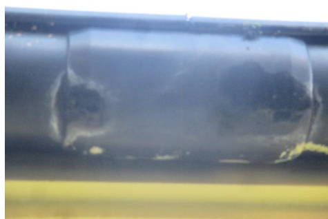
Lekkasje i renneskjøt.
