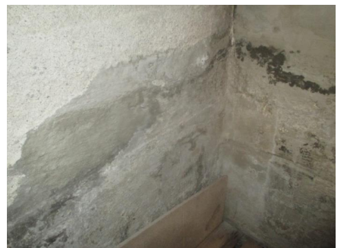
Fuktmerker og fuktvandring.
