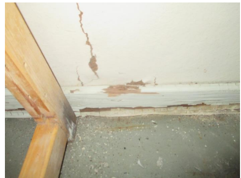
Fuktskader i en mindre del av grunnmur som er blitt foret ut.
