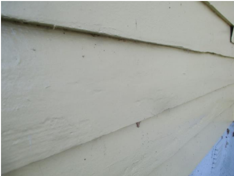
Kledningen er noe slitt flere plasser.
