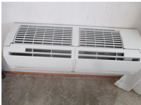
Varmepumpe i stue.
