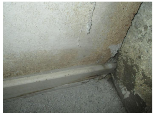
Fuktskader i skillevegg.
