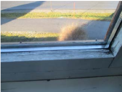
En del innvendige kondensmerker på karm og ramme.
