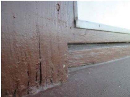
Slitasje på utvendig karm og ramme med belistninger.
