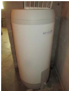
Nyere bereder er plassert i grovkjeller.
