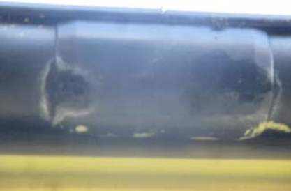
Lekkasje i renneskjøt.
