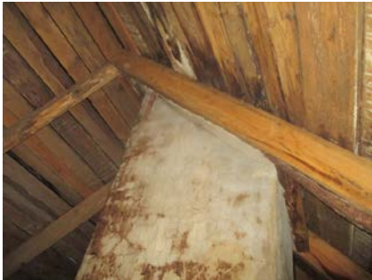
Eldre fuktmerker i rundt pipe.
