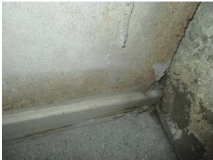
Fuktskader i skillevegg.
