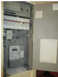
Sikringsskapet er plassert i gangen på loftet.
