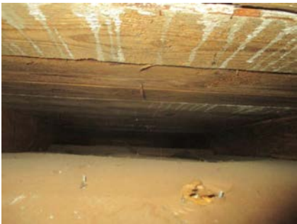
Ingen isolasjon i skråtak.
