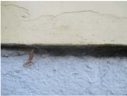
Lite tilgang på luft ved grunnmur på opprinnelig del.
