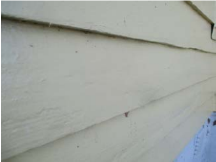
Kledningen er noe slitt flere plasser.
