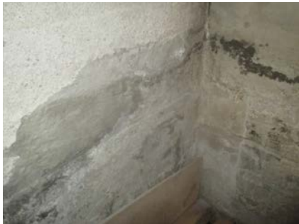
Fuktmerker og fuktvandring.
