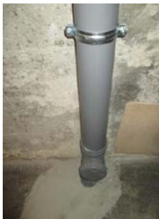
Avløpsrør av plast med stakeluke.
