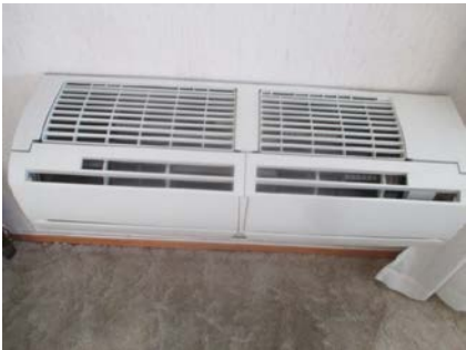
Varmepumpe i stue.
