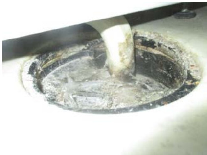
Sluk ved dusjkabinett.
