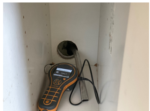
Fuktmåling i baderomsvegg fra kjøkkenskap
