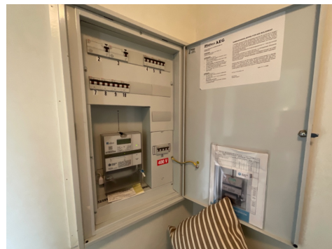
Sikringsskap i boden
