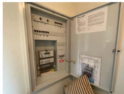
Sikringsskap i boden
