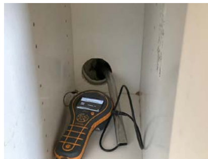
Fuktmåling i baderomsvegg fra kjøkkenskap
