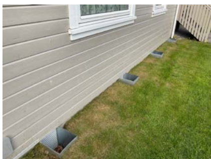
Ventilasjon i grunnmuren
