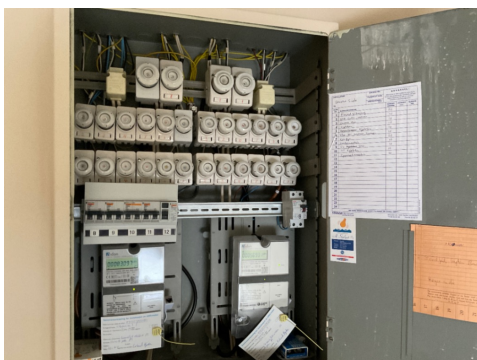
Sikringsskap i fellestrappegang
