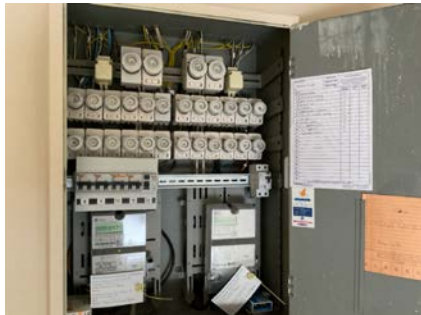
Sikringsskap i fellestrappegang
