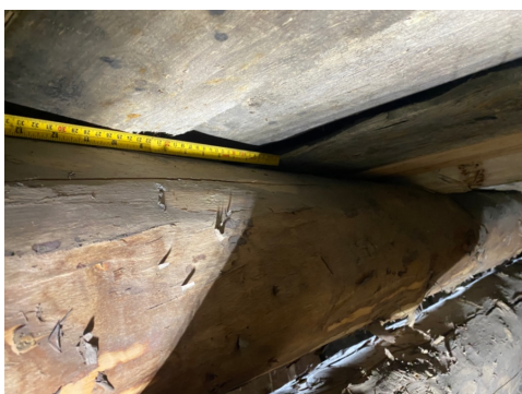
Åpninger mellom bord mot stubbloft.
