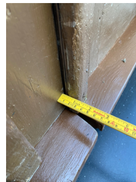
Det er påvist utetthet/åpning mellom dørblad og dørkarm. Dvs. at kald trekk kan oppstå.
