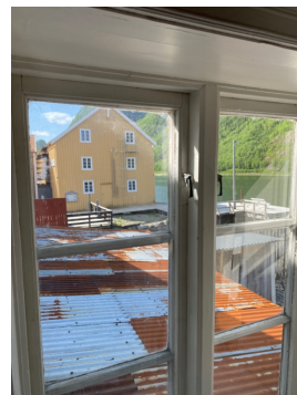
Det er ikke etablert ventiler i vinduer/vegger.
