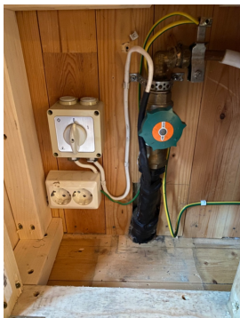
Stoppekrane, Vannledning med elvestad varmekabel.
