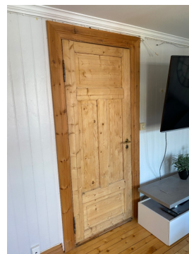
Det er påvist skjevheter i vegger.
