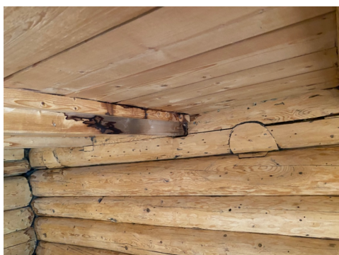
Fuktmerker mot tak.
