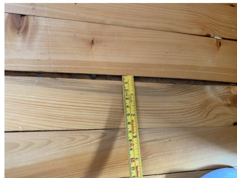
Tørke i skjøte gulv.
