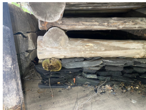
Råteskader i nederste tømmerbjelke.
