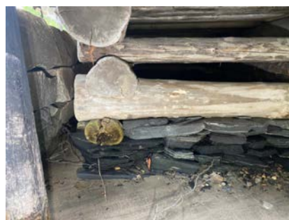
Råteskader i nederste tømmerbjelke.
