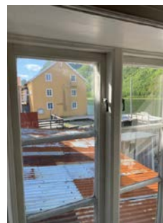
Det er ikke etablert ventiler i vinduer/vegger.
