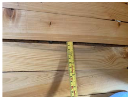
Tørke i skjøte gulv.
