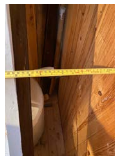
Åpning mellom trapp og vegg.
