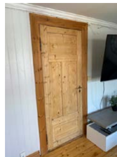
Det er påvist skjevheter i vegger.
