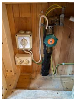
Stoppekrane, Vannledning med elvestad varmekabel.
