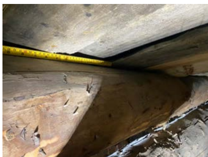
Åpninger mellom bord mot stubbloft.
