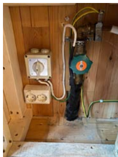
Stoppekrane, Vannledning med elvestad varmekabel.
