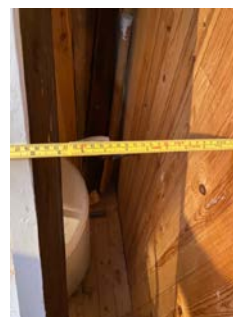
Åpning mellom trapp og vegg.
