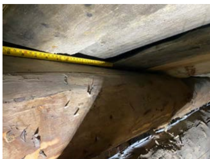
Åpninger mellom bord mot stubbloft.
