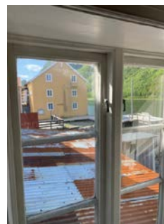
Det er ikke etablert ventiler i vinduer/vegger.
