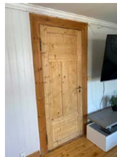
Det er påvist skjevheter i vegger.
