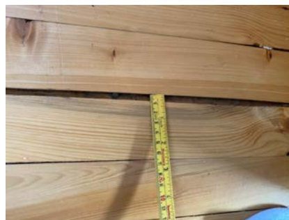
Tørke i skjøte gulv.
