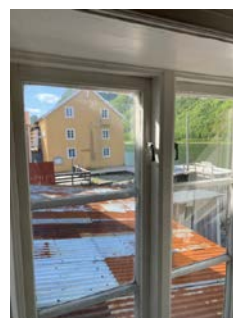
Det er ikke etablert ventiler i vinduer/vegger.
