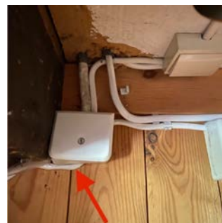
Ufagmessig montering av koblingsboks.
